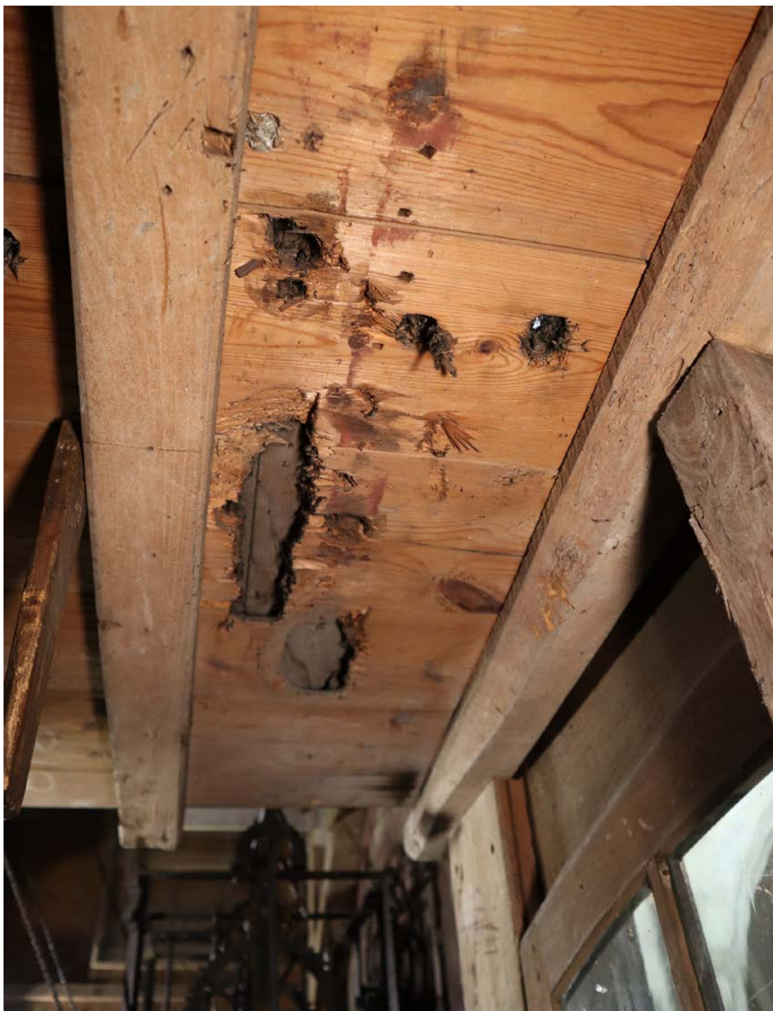
Trous dans le plafond et au fond le bâti de l'horloge
